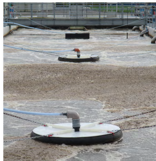
Großtechnische Haubenmessungen auf dem Klärwerk Pforzheim
